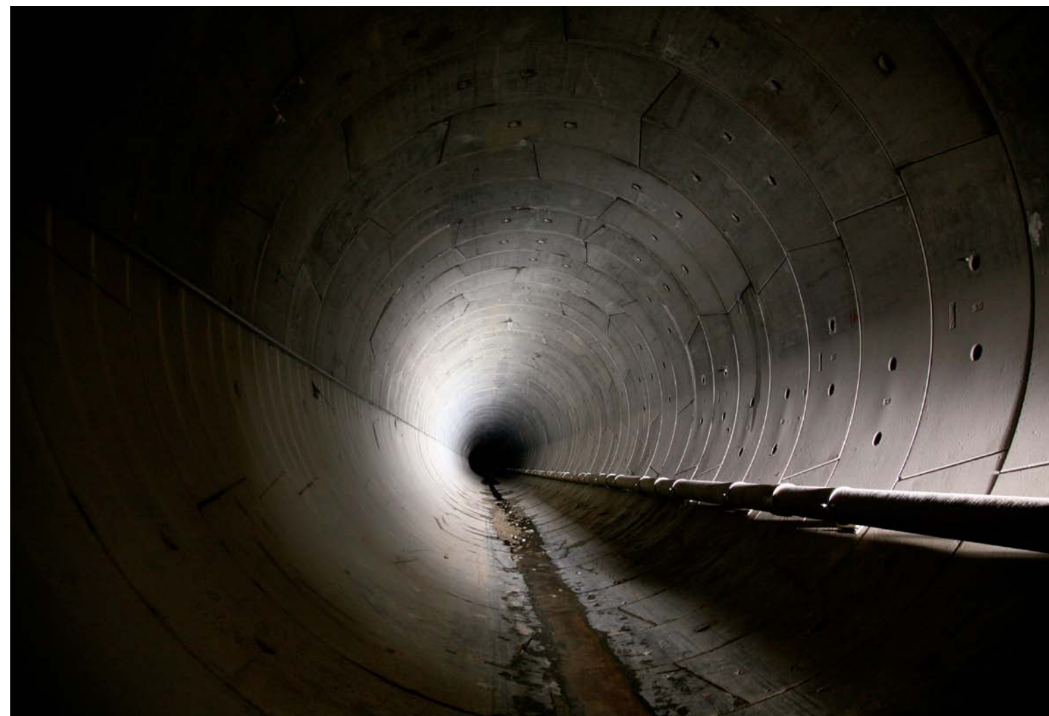
TIMA. Un tunnel de stockage des eaux en temps de pluie (longueur 2 kms et diamètre 6m80), 2009 / pour le SIAAP
